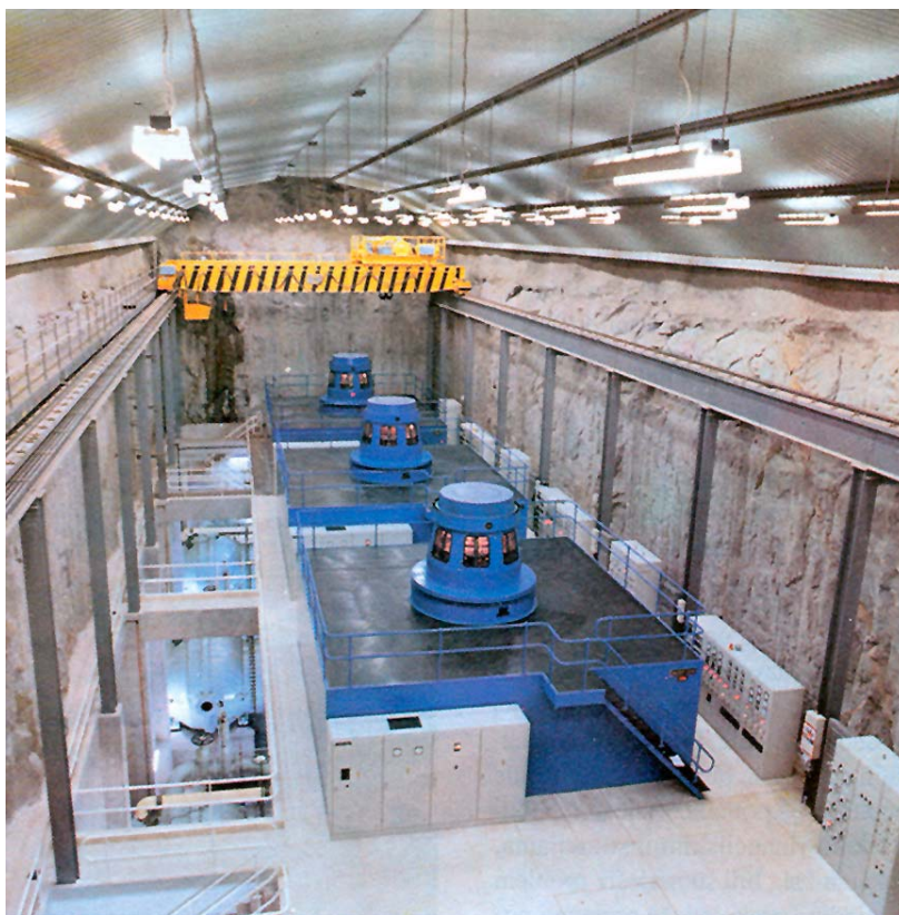
Strojarnica hidroelektane Kambur u Keniji
